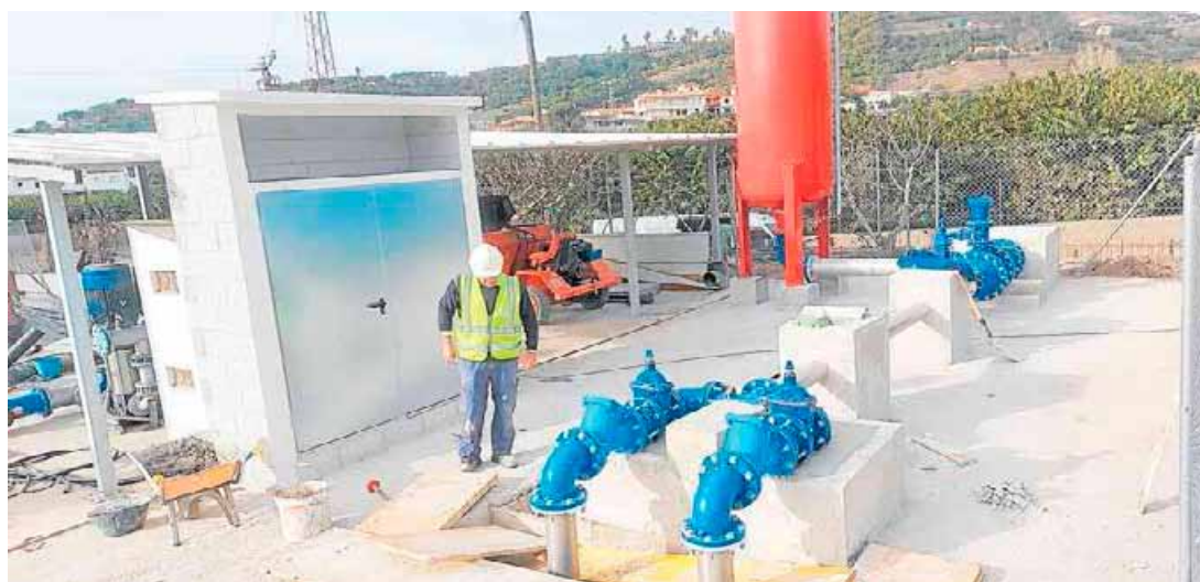
Sistema terciario de la depuradora de Almuñécar. M. J. A.
